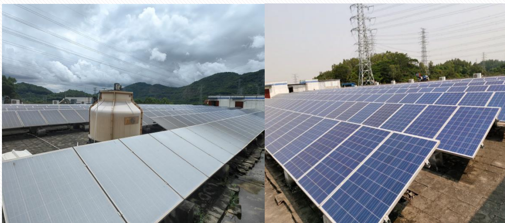
光伏发电案例
